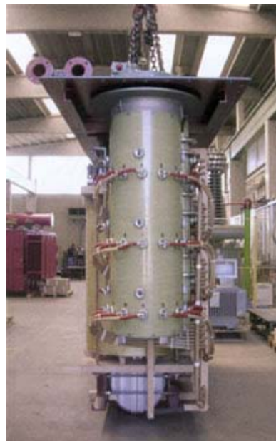
16 MVA kV 33 9x1,15% - Parte activa
